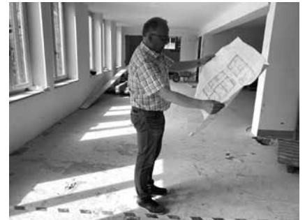
Fritz Zellner hat den Fortschritt der Bauarbeiten für die neue Saunalandschaft fest im Blick.
